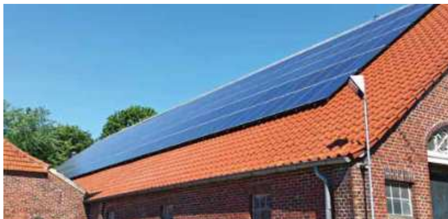
Photovoltaikanlage auf dem Stallgebäude
