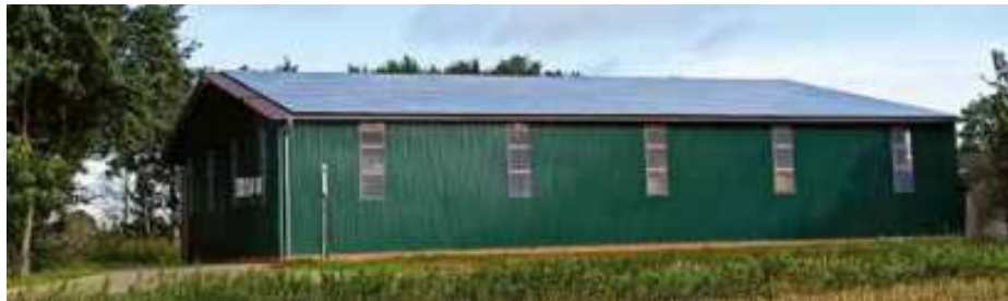
Photovoltaikanlage auf einer Maschinenhalle
